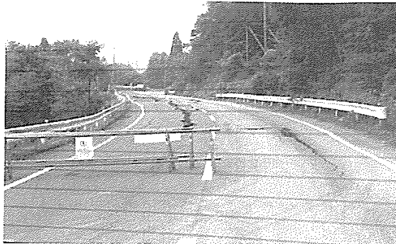
写真一 斜面を走行する2車線道路では谷側の盛土部分の車線が地震時に大きく被災する事例
