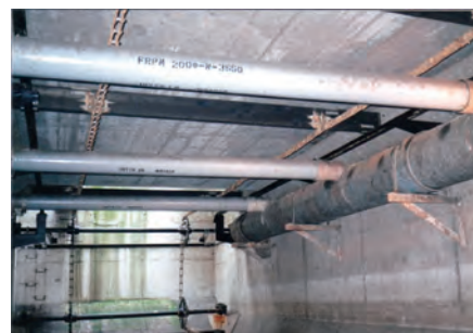
写真2. 3層式最終沈殿池の中層 (枝管と主管が見える。)
