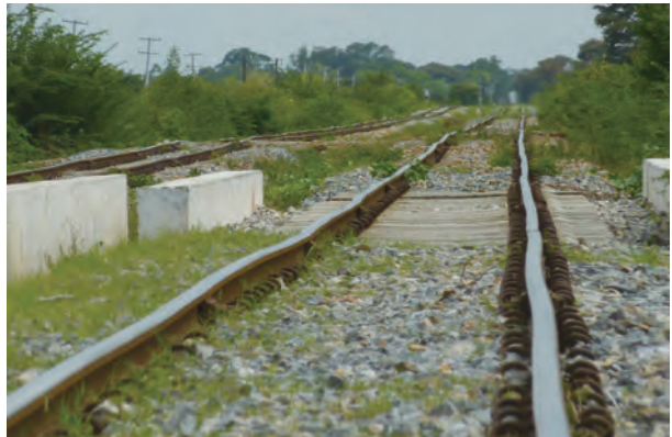
写真7 橋梁前後の軌道狂いが大きい箇所
