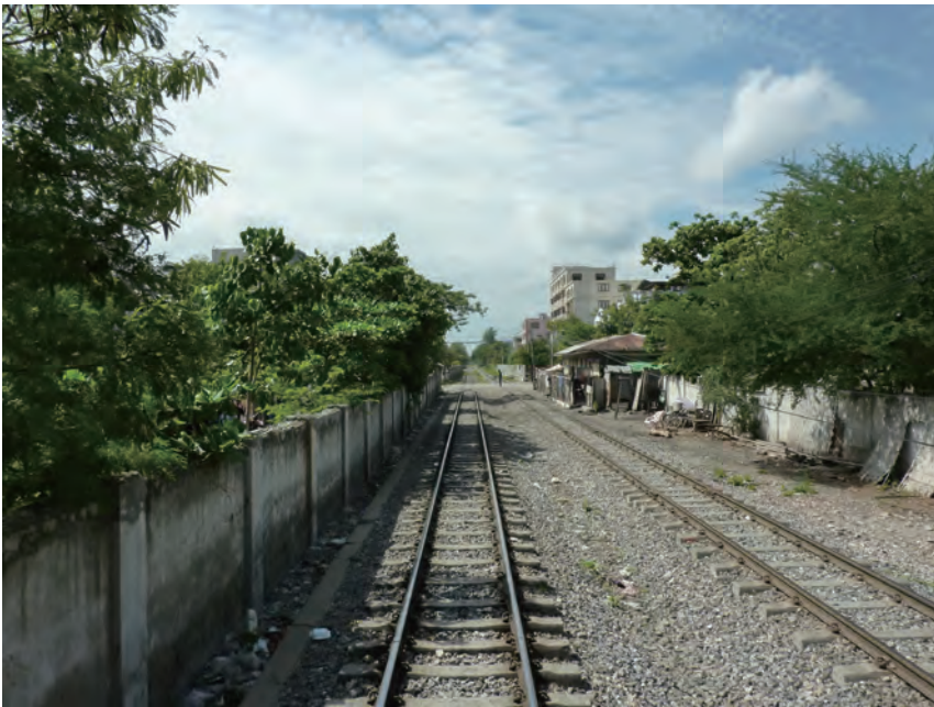
写真9 バラストが不足しPCマクラギの端面が殆ど露出している
