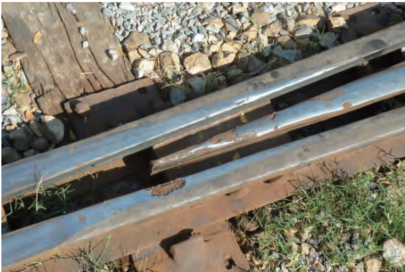
写真8 クロッシングのノーズレールとウイングレールがかなり損傷している
