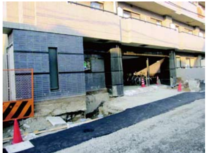
写真-2 液状化による集合住宅の基礎の抜け上がり (千葉県浦安市今川)
