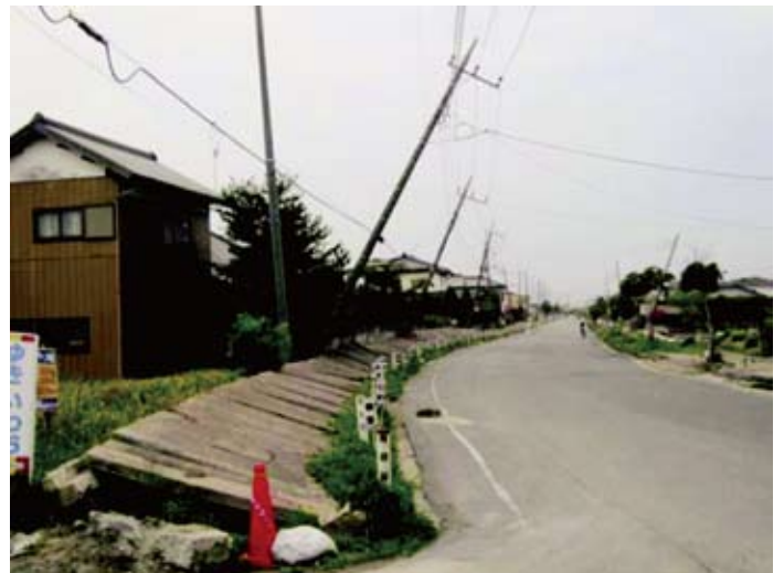
写真-4 液状化によるボックスカルバートの浮上 (茨城県潮来市日の出)
