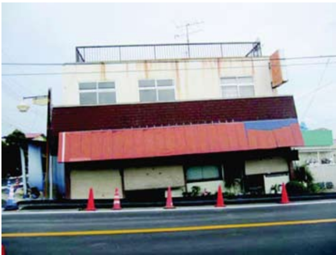
写真-1 液状化による戸建住宅の沈下と傾き (千葉県我孫子市布佐)
