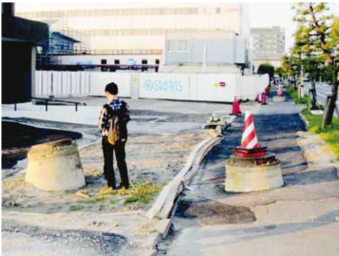
写真-3 液状化によるマンホールの浮上 (千葉県浦安市日の出)
